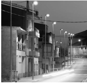
Figura 1.5. Instal·lació d'enllumenat exterior.
